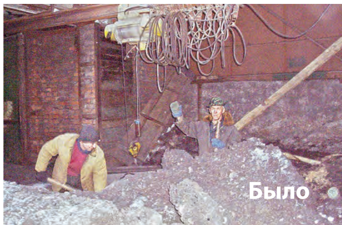
В угольной котельной, 2002 г.
