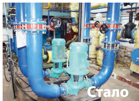
Современные насосы в газовой котельной (ул. Гагарина, 15 «а»), 2018 г.
