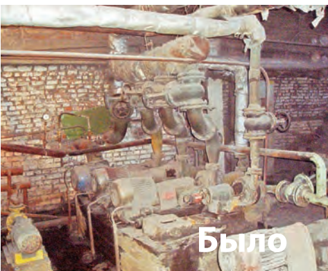
Оборудование в угольной котельной, 2003 г.
