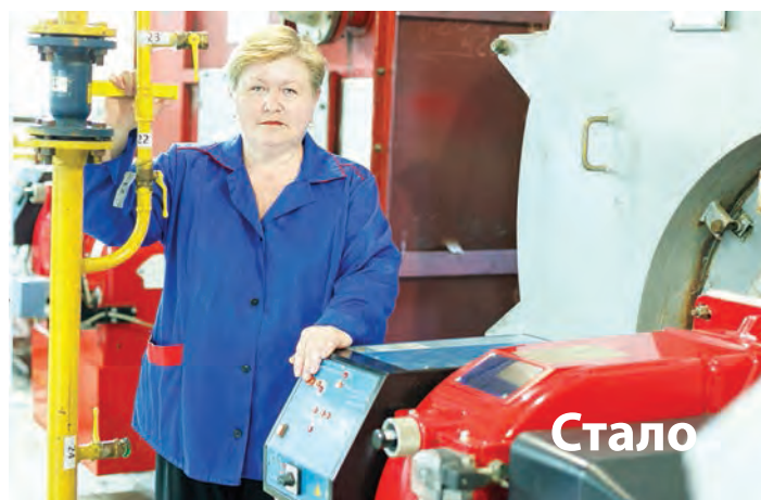
Оператор Людмила Щуркова в газовой котельной по ул. Пугачева, 143 «а», 2018 г.
