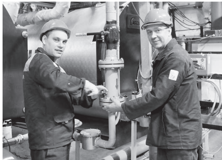
Слесарь Виктор Котов и электросварщик Сергей Подкин проводят техническое обслуживание газопровода в котельной по ул. Раскольников, 146 «д»
